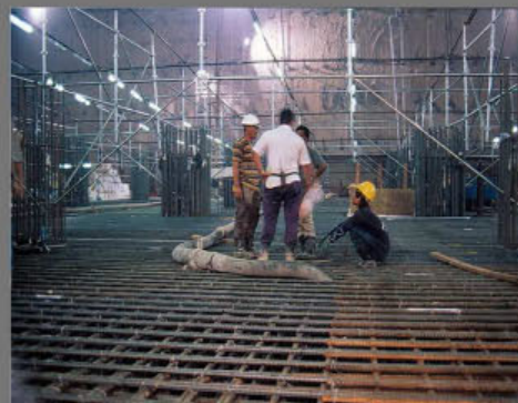
Probleme auf der Baustelle?
